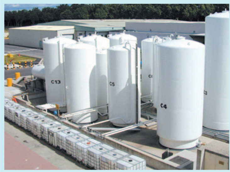
Stockage des Neutralène® et des Bioclean® pour des livraisons en vrac ou en containers GRV
